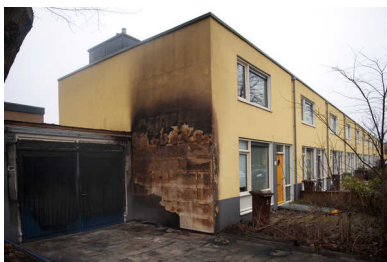
Schade aan een woning en een garage op de plek waar in een auto in brand werd gestoken.
